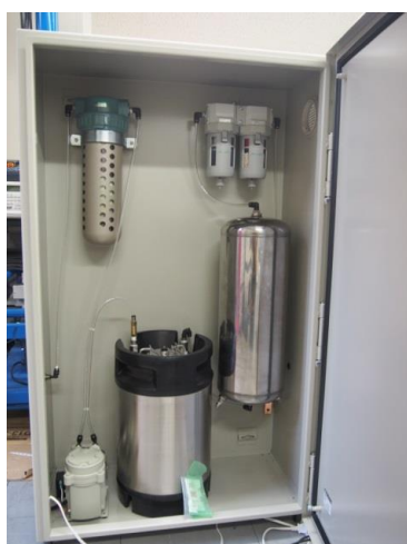
写真 24 : CO・CO 2 除去装置
