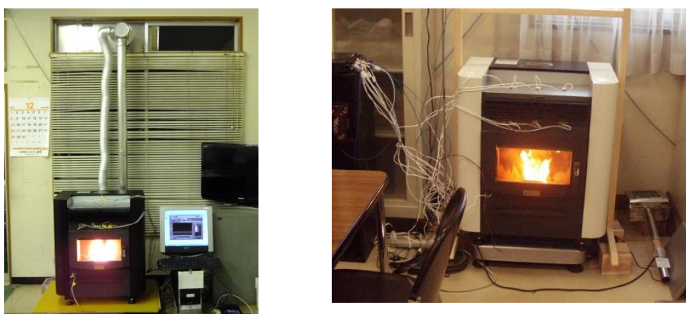
図 8 利用実証中のペレットストーブ (左：群馬県前橋市に設置、右：東京都八王子市に設置)
