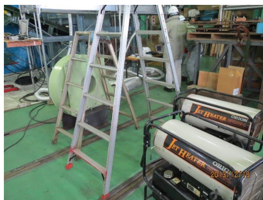
図 15 送風機と加熱ジェットヒーター
