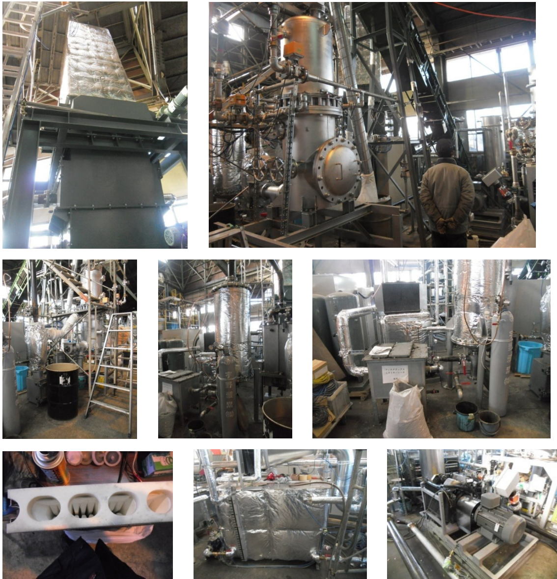
図 24 ガス化炉設備外観
